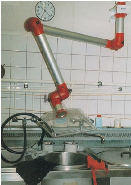
Abbildung 12b: Flexible Punktabsaugung über einem Färbebecken (Landmann)
