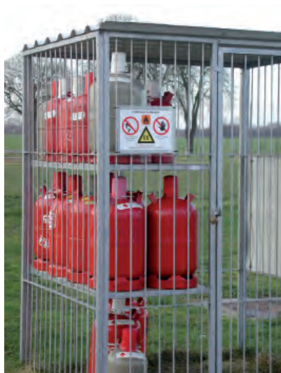
Abb. 46: Ordnungsgemäßes Lagern im Freien
