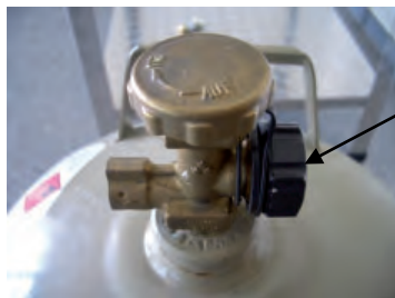
Abb. 41: Flüssiggasflaschen-Absperrventil mit aufgeschraubter Ventilver- schlussmutter
