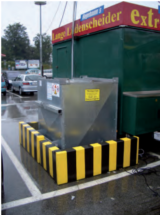
Abb. 49: Flüssiggas-Fass mit Schutzmaßnahmen (z. B. Anfahrerschutz, Flaschenschrack)
